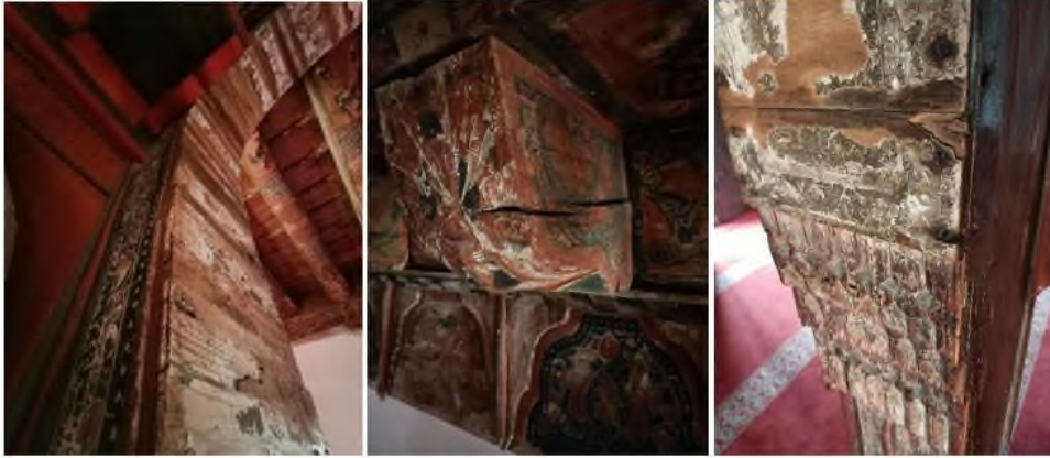
Görsel 30: Kasaba Köyü Mahmut Bey Camii'nin ahşap yüzeylerine uygulanan bezeme detaylarında meydana gelen bozulma durumları
